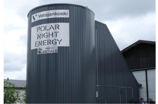
Komercyjny piaskowy (100 ton) magazyn ciepła działający na terenie elektrowni Vatajankoski, Finlandia
